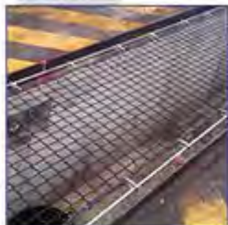
Redes de protección de fosos
